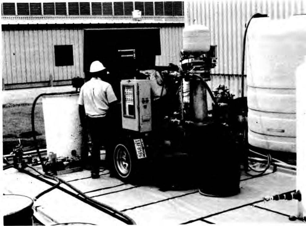
Fig. 3. Dry Backflushable Filter System at Byron.
